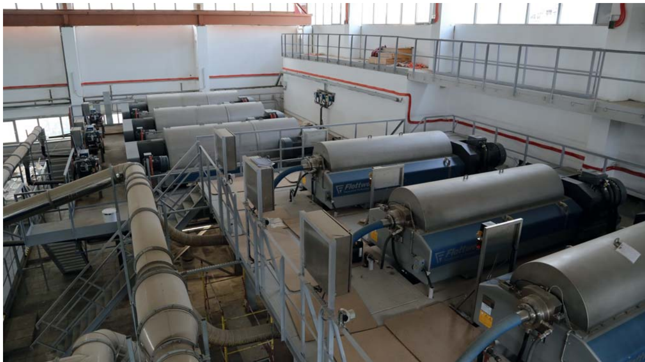
Центрифуги в реконструированном цехе механического обезвоживания
