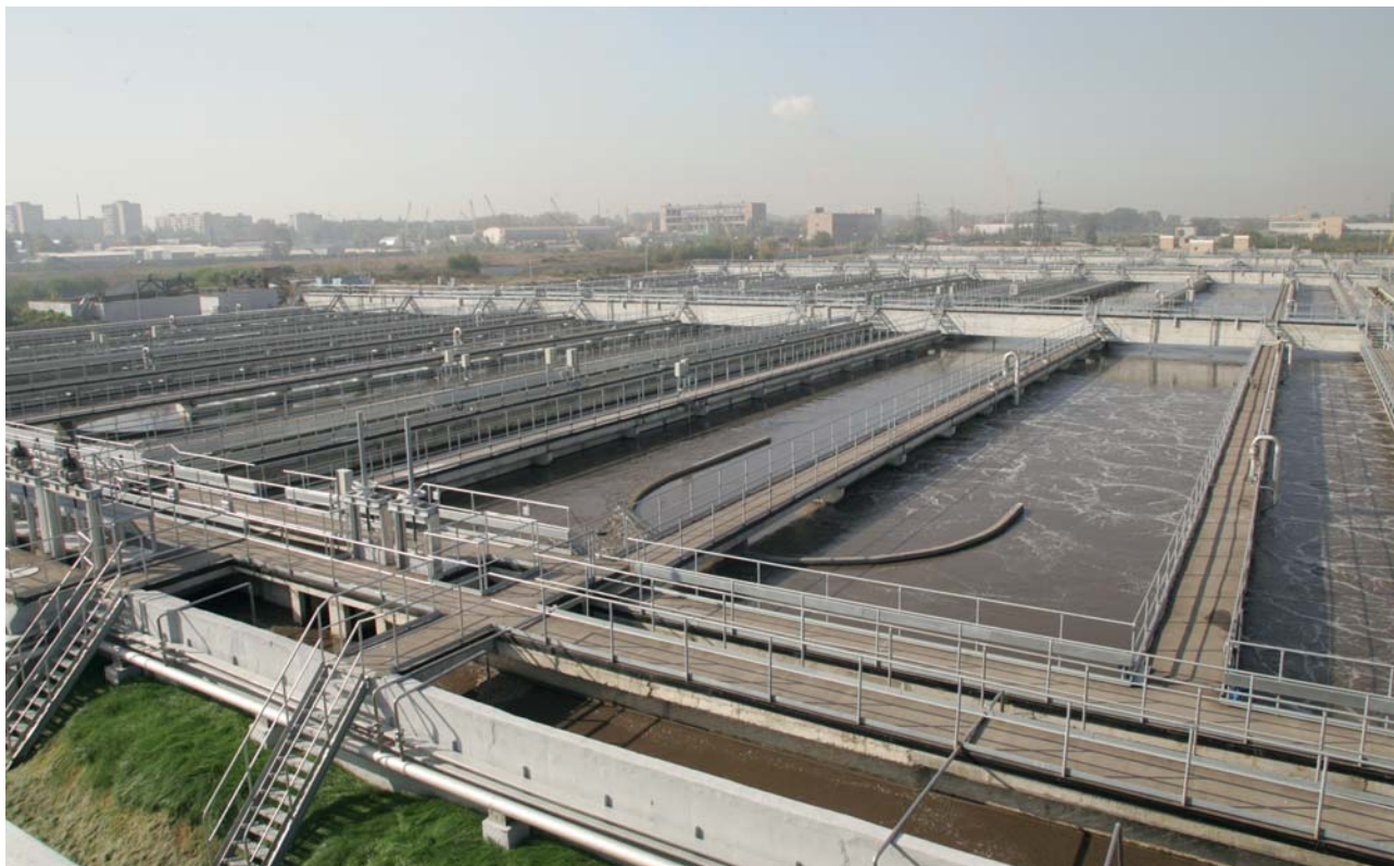
Общий вид аэротенков блока удаления биогенных элементов
