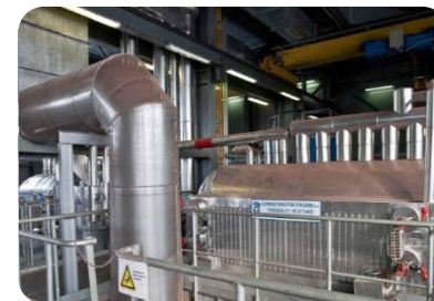
ЗСО на Юго-Западных очистных сооружениях (ЮЗОС) запущен в 2007 году Проектная производительность – 88 тонн сух. в-ва/сут.
