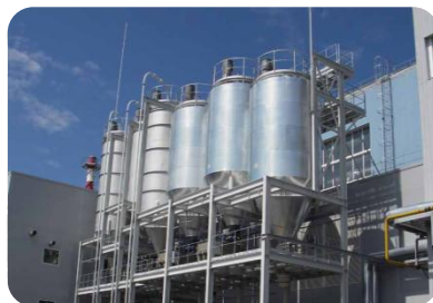
ЗСО на Северной станции аэрации (ССА) запущен в 2007 году Проектная производительность – 186 тонн сух. в-ва/сут.
